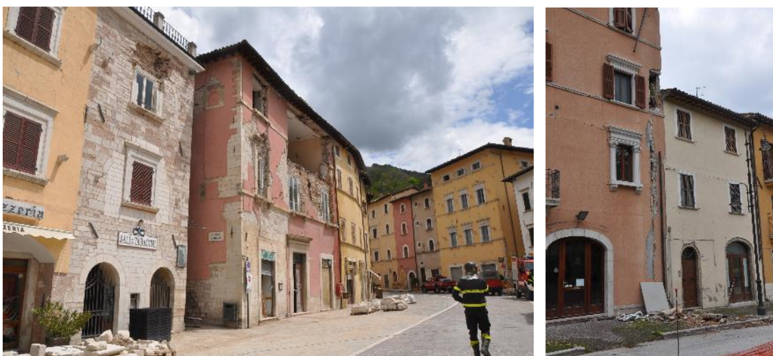
Fig. 1 – Danos para fora do plano e no plano em agregados existentes, após o terramoto no centro de Itália de 2016, em Visso (Fotografias: A. Penna).
