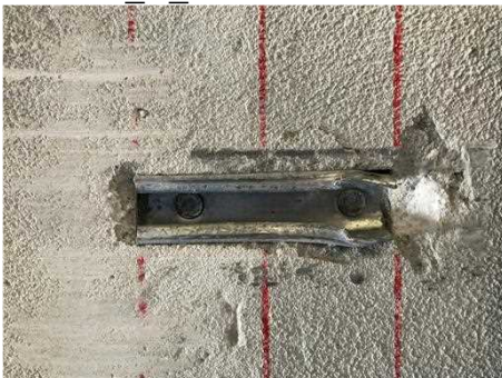
e) Painel após falha CPC_O_06
