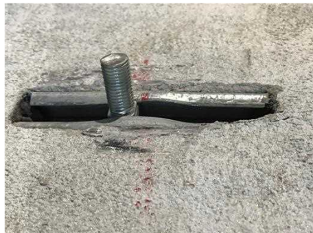
f) Deformação canal, sem falha CPC_O_09
