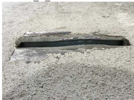
h) Deformação canal, sem falha CPC_O_10
