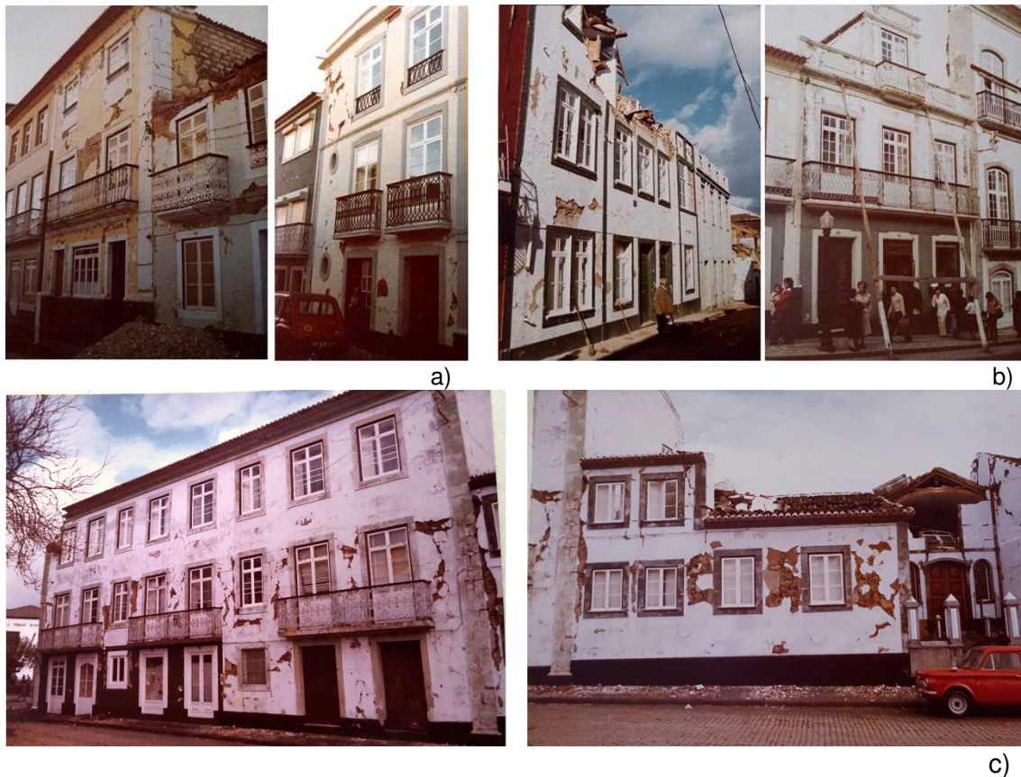
Fig. 2 – Danos severos em edifícios de alvenaria – Sismo dos Açores de 1980 [2]: a) Danos nos nembos devido ao impacto entre edifícios; b) Mecanismos locais associados à resposta fora do plano das paredes; c) Danos nos nembos (no plano das paredes).
